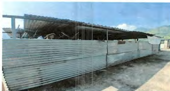
Foto 4: Este espacio está en mal estado y con los pórticos se mejorará el espacio físico
