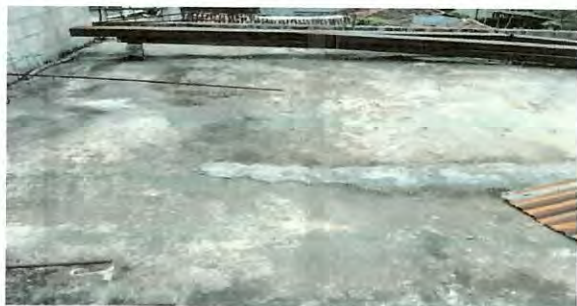
Foto 3: Parte del espacio donde se filtra el agua y con la construcción de los pórticos se evirará
